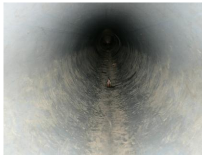
図6 足跡が残る排水管内
