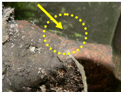
図7 体毛が付着した排水管の入り口
